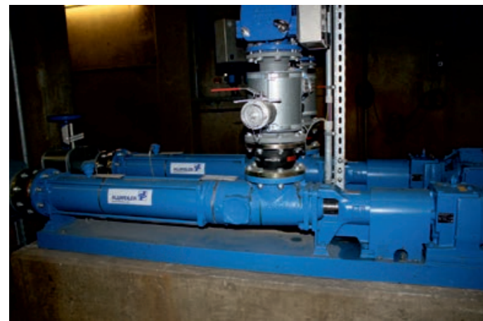
Etwa 80 % aller Pumpen der Anlage sind von Allweiler®. Das Bild zeigt die Dünnschlammumpfen.
