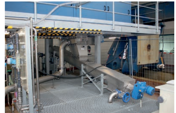
Der Schrägförderer fördert von oben in den Silo. Die Förderhöhe beträgt etwa 11 m.
