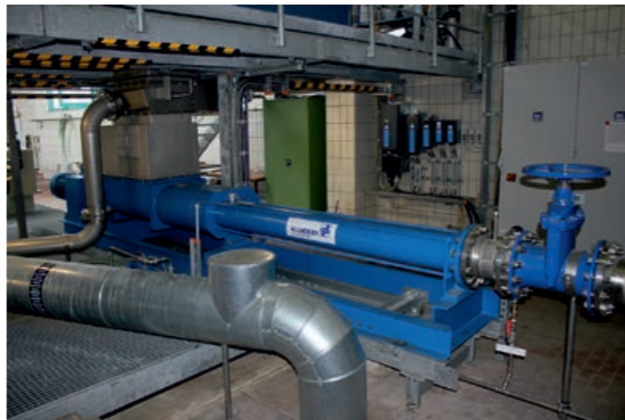
Vierstufige Feststoff-Exzentrerschneckenpumpe vom Typ AE4N1450-RG Fabrikat „Allweiler®“ als Restschlamm-austragspumpe unter der Zentrifuge
