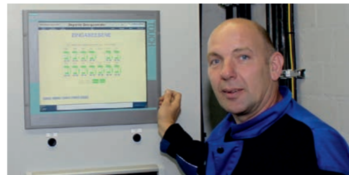
Falko Sellenk, Industriemechaniker beim Betreiber Sira und verantwortlich für die Pumpen auf der Deponie: „Die Pumpen sind außerordentlich zuverlässig und wartungsarm. Unser Ersatzteilbedarf in den letzten Jahren bestand aus zwei Statorn und einem Gelenk.“
